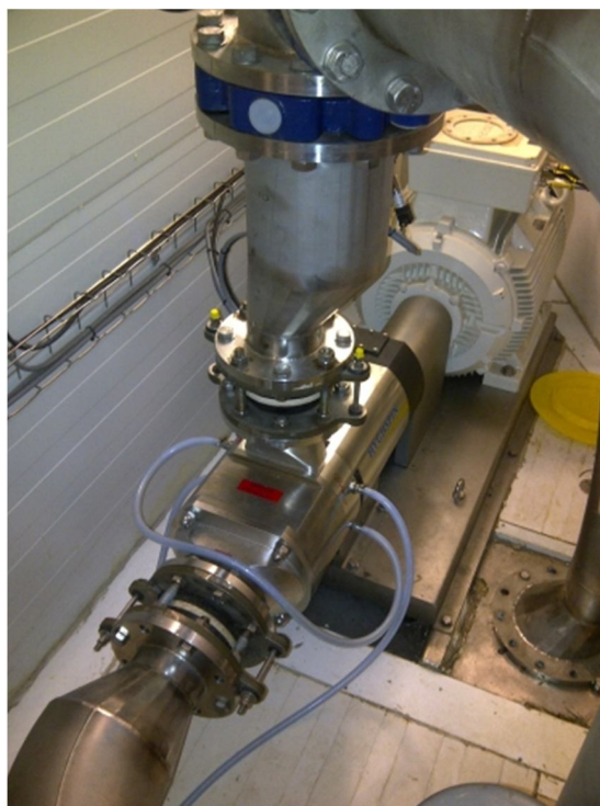
HYGHSPIN 125-Pumpe mit Grundplatte installiert auf einem Fruchtsafttanker
